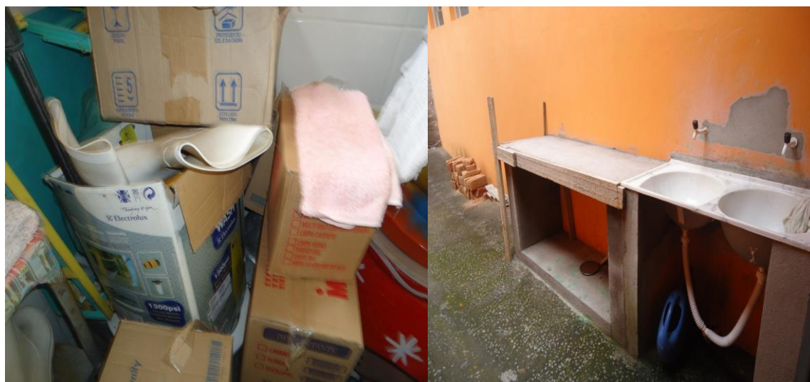
Figura 05: Depósito de Material de limpeza, sem espaço adequado
