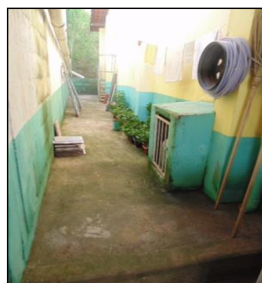
Figura:05-parede acometida pela chuva
