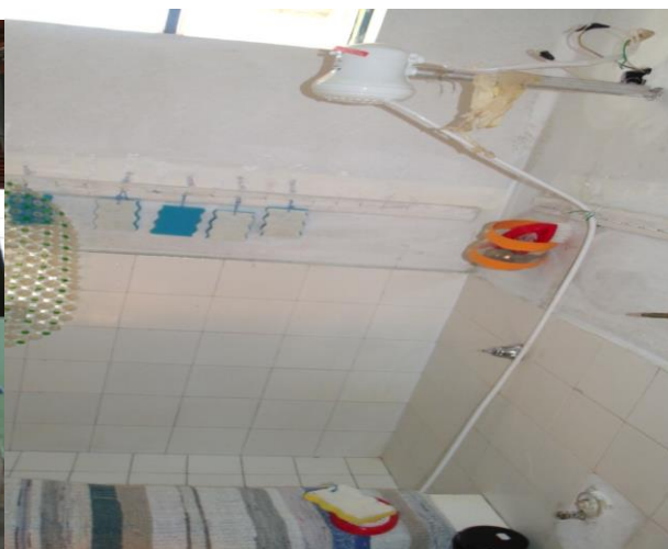
Figura 03: Banheiro com chuveiro
