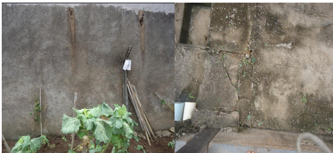
Figura 16: Paredes e muros acometidos
