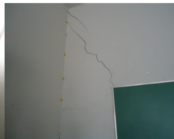
Figura 12- Rachadura nas paredes
